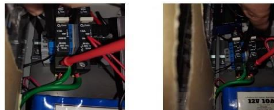
Gambar 6. Pengukuran pada masukantegangan solar panel dan keluaran tegangan baterai.
