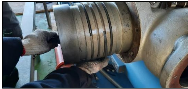
Gambar 8. Kondisi Ring Piston Sebelum Diganti
