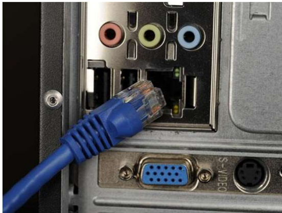
Port dan Kabel Ethernet/LAN pada PC
