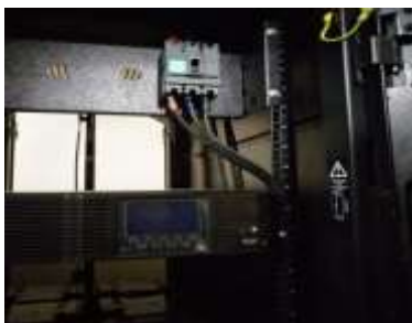
Gambar 4. Tampak depan UPS
