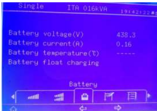
Gambar 12. Display Battery UPS dalam kondisi Full Charging
