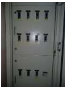
Gambar 3. Tampak dalam Panel UPS
