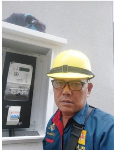
Gambar 3. 7 Pasang Baru 3 Phasa (Box Oka)
