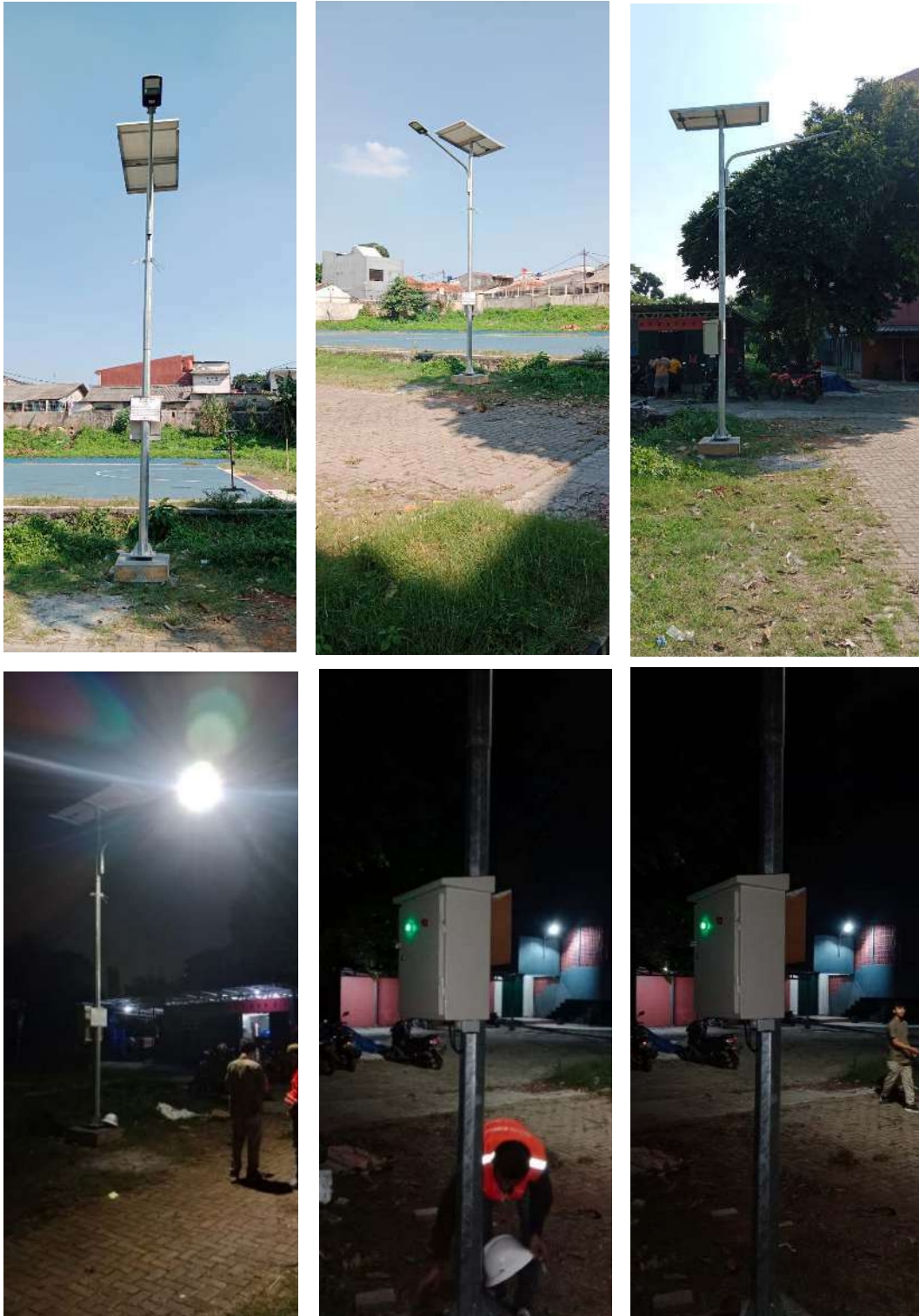
Gambar 3.9 PJUTS 200WP Laboratorium Teknik FK UNKRIS
