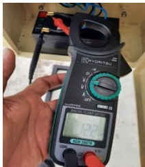
Gambar 3. 17 Pengukuran Tegangan Baterai 12 Volt
