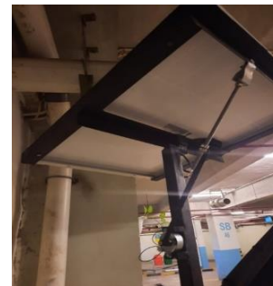
Gambar 2. 9 Tracking Solar (sumber : Dokumen pribadi )
